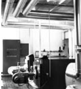
Die Heizungsanlage der Kolonie Letten IV
