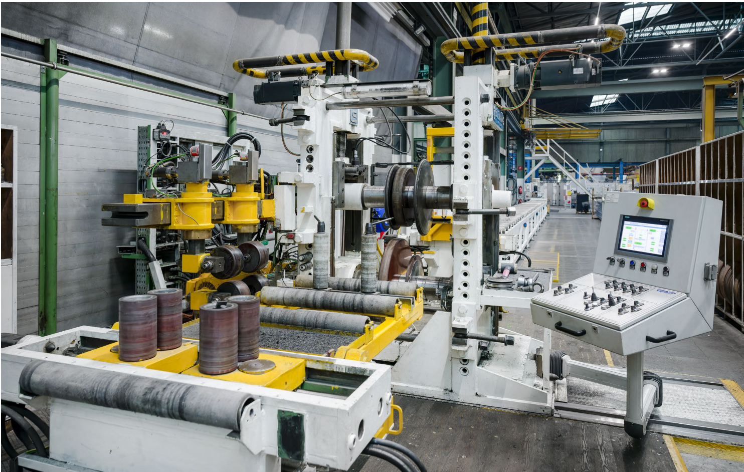
Nur wenige Personen können die Richtmaschine für Spezialprofile bei Constellium bedienen. Bei der Nachrüstung musste sich der Automatisierungsspezialist GAP Engineering in die Lage des Maschinenpersonals hineinversetzen.
