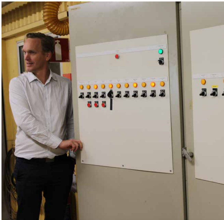
Gamla manöverknappar i reningsverket som ska byggas om. De nya styrsåpen byggs av ASB VA-automation. "Vi använder Siemens så mycket det bara går i skåpen."
