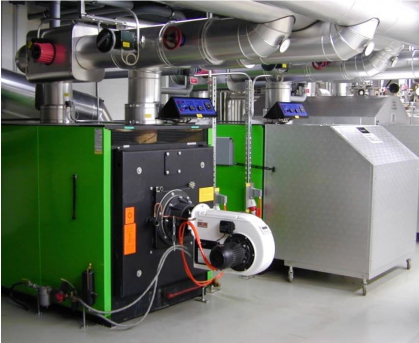
Fig. 6-4 Mehrkesselanlage (zwei Ölkessel) in Parallelschaltung angeschlossen, Kessel rechts mit Schalldämmhaube
