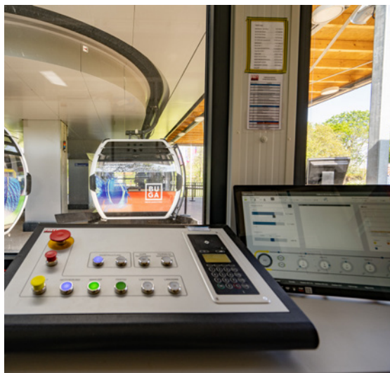
Von der zentralen Leitstelle aus werden die Fahrgäste bei Bedarf via IWLAN und Voice-over-IP-Sprachnachrichten informiert.
