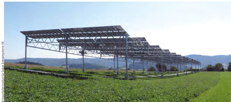
Abb. 18: Agrophotovoltaik Pilotanlage: Aufständigung der PV-Module auf mehreren Metern Höhe.
