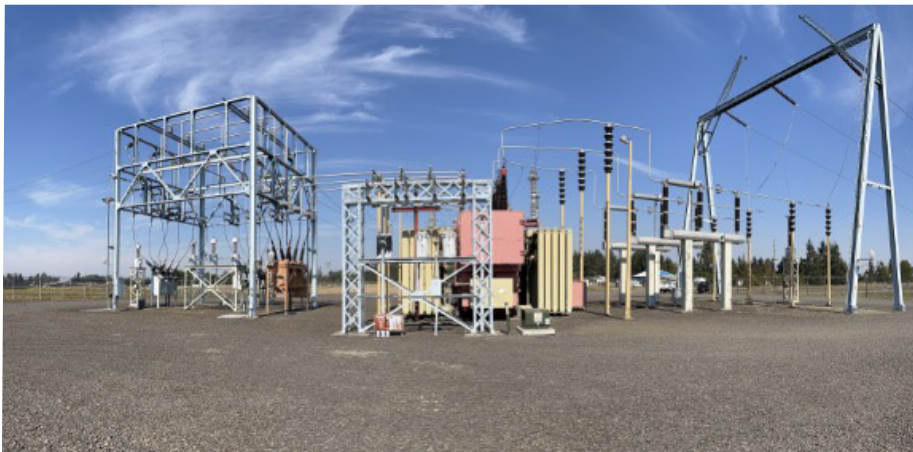
Equipo antiguo en la Subestación Monitor
