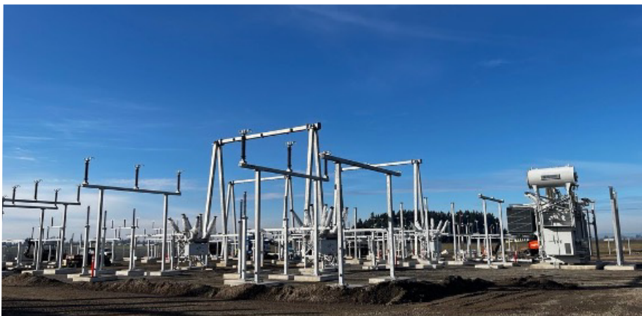
Subestación Monitor recién actualizada
