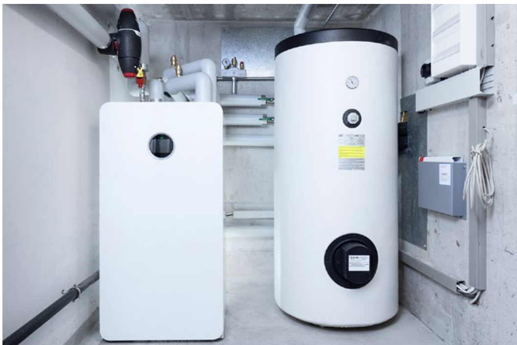
Alles neu im Heizkeller: Inneneinheit der Wärmepumpe und Boiler.
