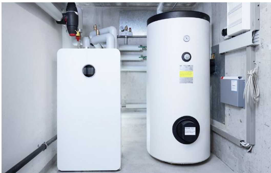
Les nouveaux dans la chaufferie : l'unité intérieure de la pompe à chaleur et le chauffe-eau.
