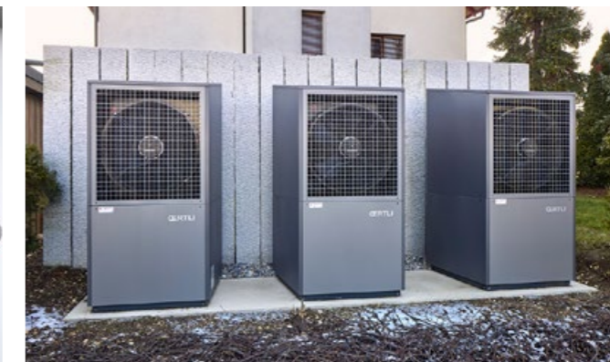
L'ancienne chaufferie abrite les unités intérieures des trois pompes à chaleur (tout à gauche). Grâce à la palissade en granit (à gauche), il n'y a aucun problème de bruit pour le lotissement (en bas).
