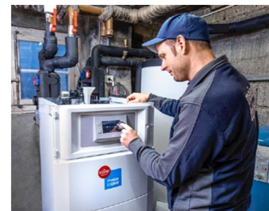
Pendant ce temps, Gilbert Imstepf s'occupe de la chaudière à mazout à condensation OSCR 60 du restaurant Aletschhorn.
