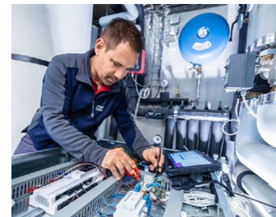
La pompe à chaleur sol-eau Oertli SIN 26TU (tout à gauche) à l'hôtel Tigilou, dont l'entretien est assuré par Christoph Wiesner (à gauche).
