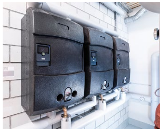
Au cœur de l'installation : trois stations de production d'eau chaude Aquanova L55K3.
