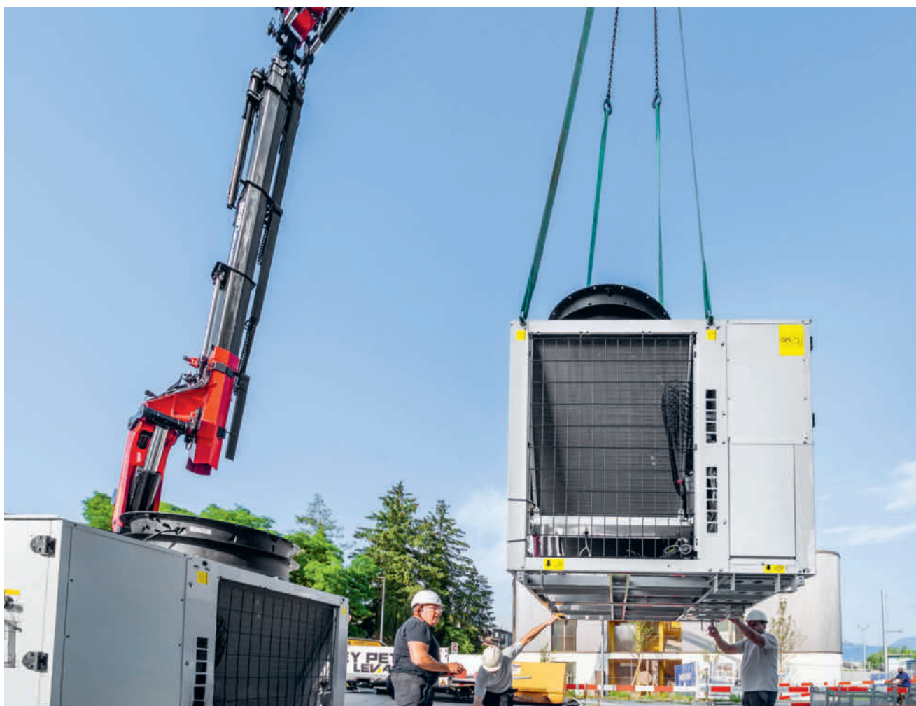
Carico prezioso a Yverdon-les-Bains: una delle tre pompe di calore Carrier AquaSnap 61AQ 100P durante le operazioni di scarico. (Foto: rp)
