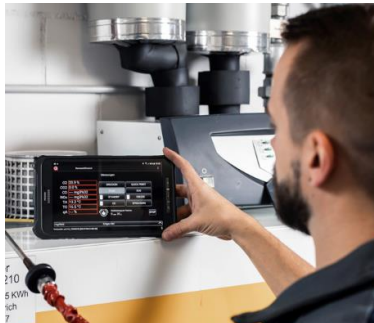
Feuerungskontrollen und Betriebsoptimierungen
