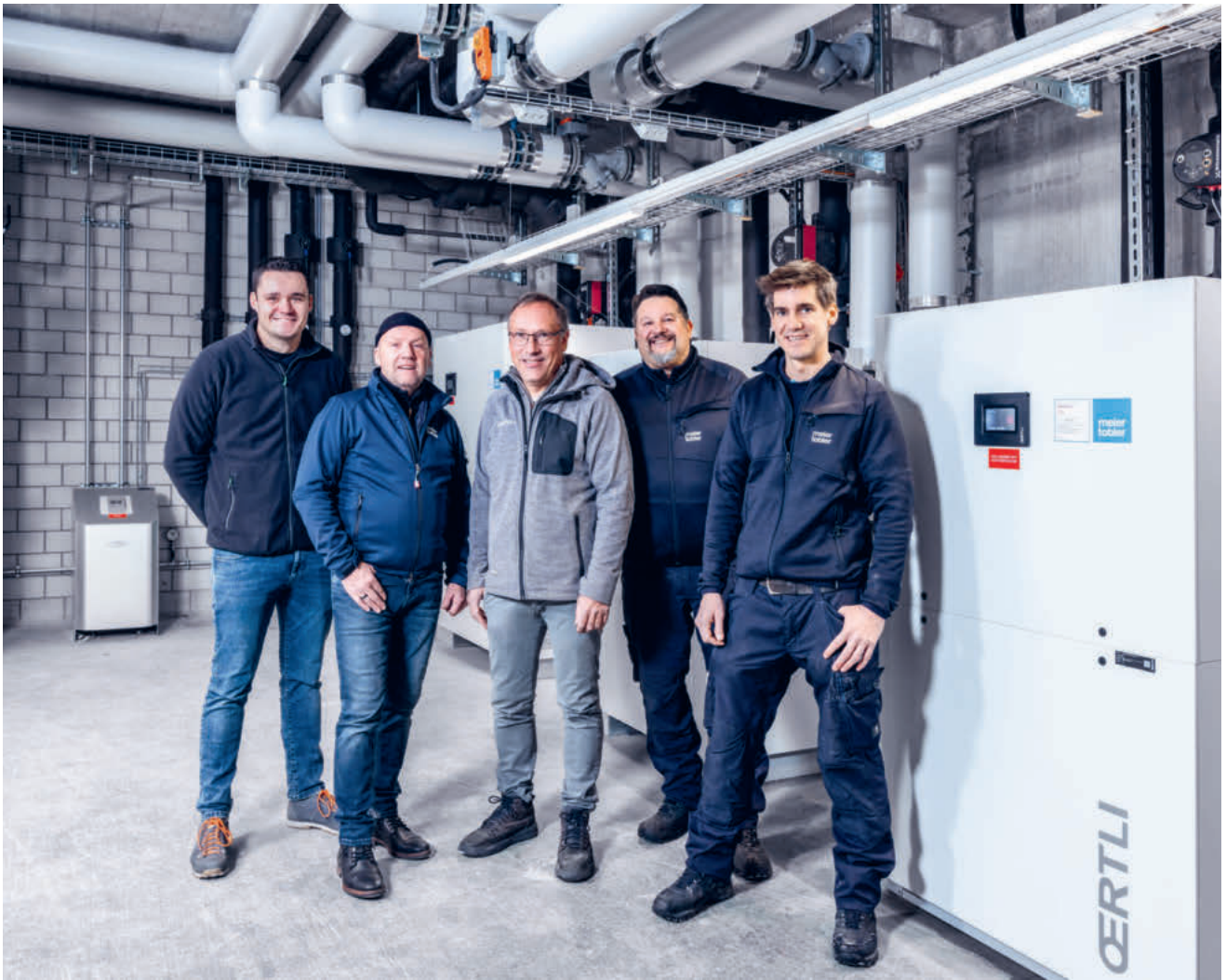
Das Umsetzungsteam im Heizkeller unterhalb des Restaurants La Motta (v.l.): Manuel Feuerstein, Reto Gerschwiler, Dario Cao sowie vom Service von Meier Tobler Ernst Engi, Teamleiter Erneuerbare, und Servicetechniker Sandro Bettini.
