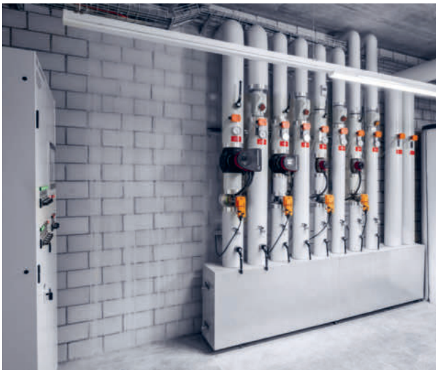
Die Wärmeverteilung mit den vier Gruppen und links der Steuerungsschrank mit dem Leitsystem.
