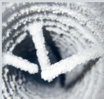
Bauschäden Fremdkörper im Lüftungssystem behindern die Reinigung und wirken als Schmutzfänger.
