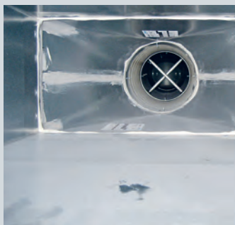
Verschmutzte Komponenten Die Lüftungsanlage ist direkt nach dem Einbau bereits mit Baustaub und Fremdkörpern verunreinigt.
