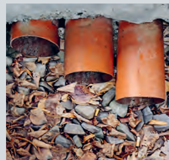
Ungeschützte Luftfassungen Fremdstoffe werden angesaugt und verunreinigen das Lüftungssystem und die Luft.
