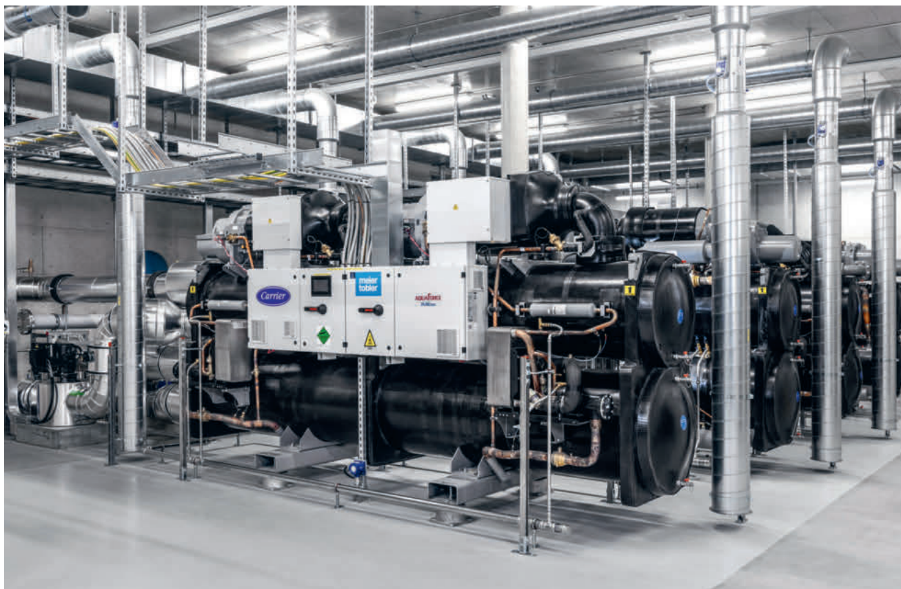
Sorprendenti: le quattro potenti pompe di calore Carrier Aquaforce 61 XWHL-ZE 17 di Meier Tobler. (Foto: rl)
