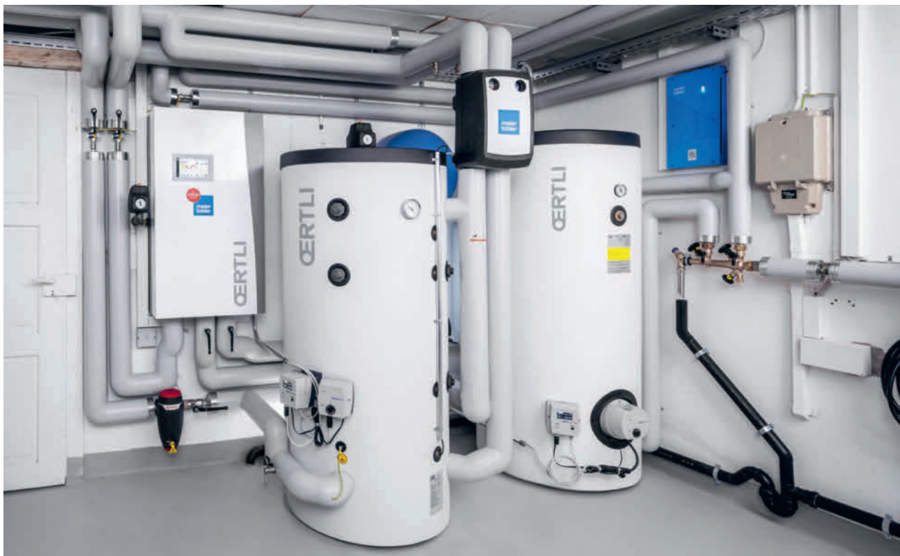
Vista interna con pompa di calore, bollitore, accumulatore di calore e cassetta blu SmartGuard sulla parete.
