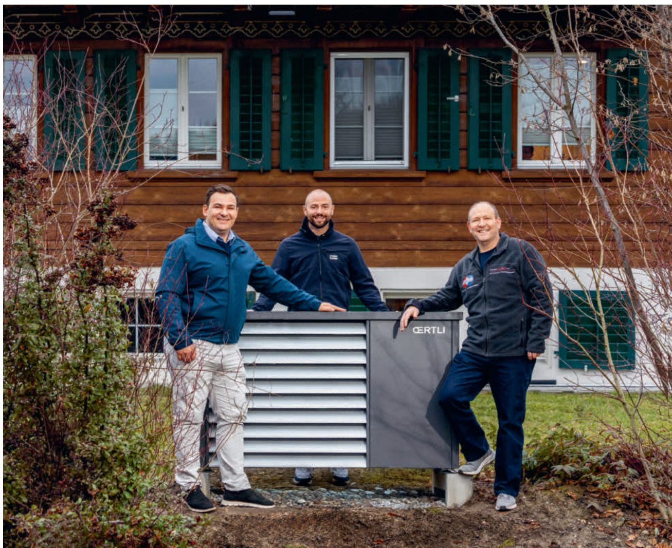
Patrick Läng (à gauche), Markus Schmid (au centre) et Marco Meier (à droite) avec l'unité extérieure de la nouvelle pompe à chaleur air-eau Oertli Aero 2-8a dans le jardin d'une maison presque centenaire. (Photos : rl)
