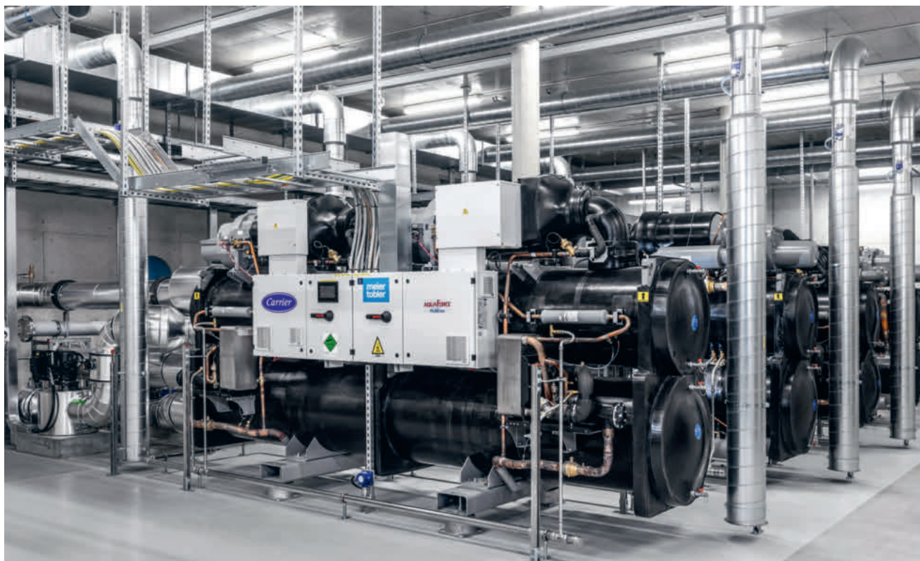
Impressionnantes : les quatre puissantes pompes à chaleur industrielles Carrier Aquaforce 61 XWHL-ZE 17 de Meier Tobler. (Photos : rl)
