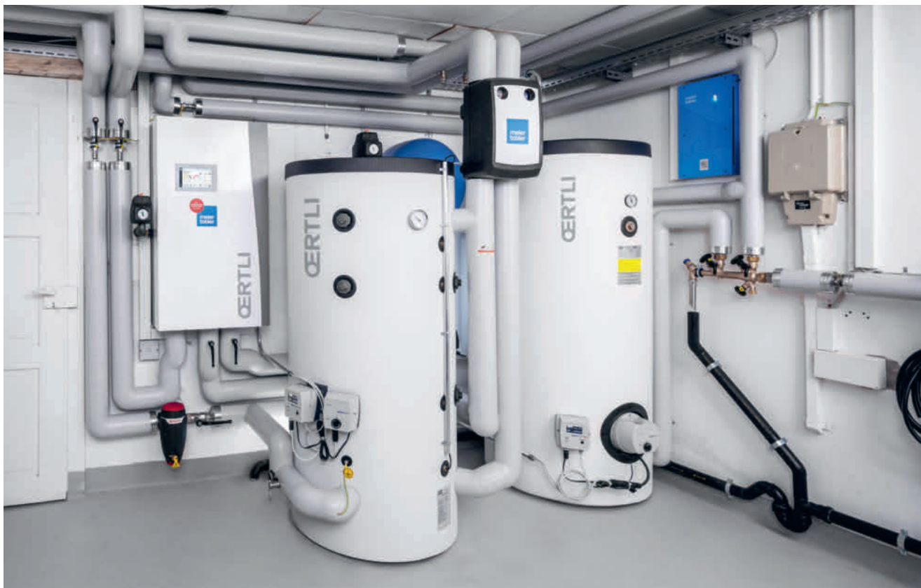
Vue intérieure avec pompe à chaleur, chauffe-eau, accumulateur de chaleur et boîtier bleu SmartGuard fixé au mur.
