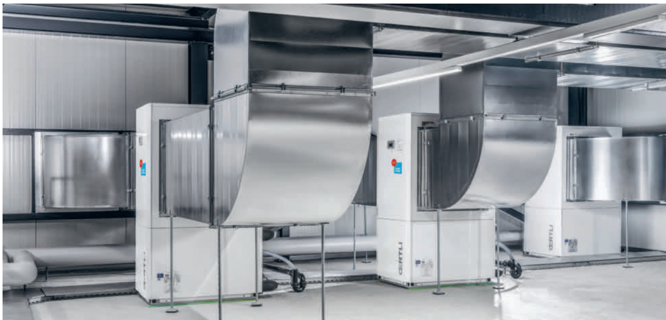
Die 3er-Kaskade auf dem Zwischendach (oben) und der Blick von da aus auf die Produktion (rechts).
