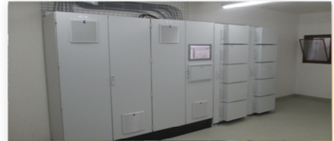
Stockage sur batterie
