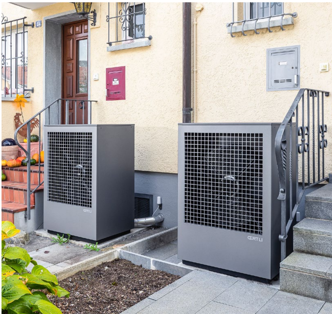
Aspetto armonioso: le due unità esterne davanti alle rispettive entrate delle case. (Foto: rl)
