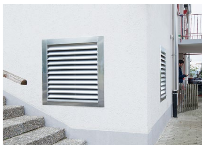
Vista esterna dell'entrata e dell'uscita dell'aria posizionate sull'angolo dell'edificio.
