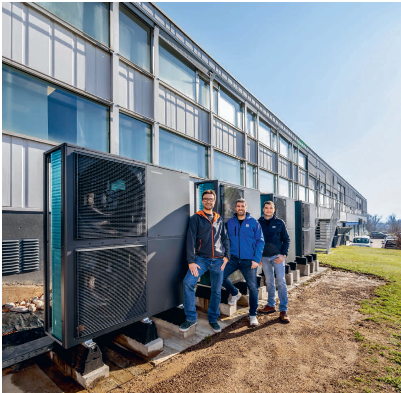
Une équipe d'installation satisfaite devant les quatre pompes à chaleur (de gauche à droite): Laurent Solari, Rodolfo Bianchi et Matteo Conti. (Photos: rl)
