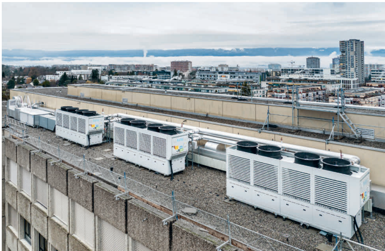
Une puissance élevée depuis le toit : la pompe à chaleur de type PICO RO 8000 (tout à gauche) et les trois pompes à chaleur industrielles AxAir Enerblue. (Photos : rl)
