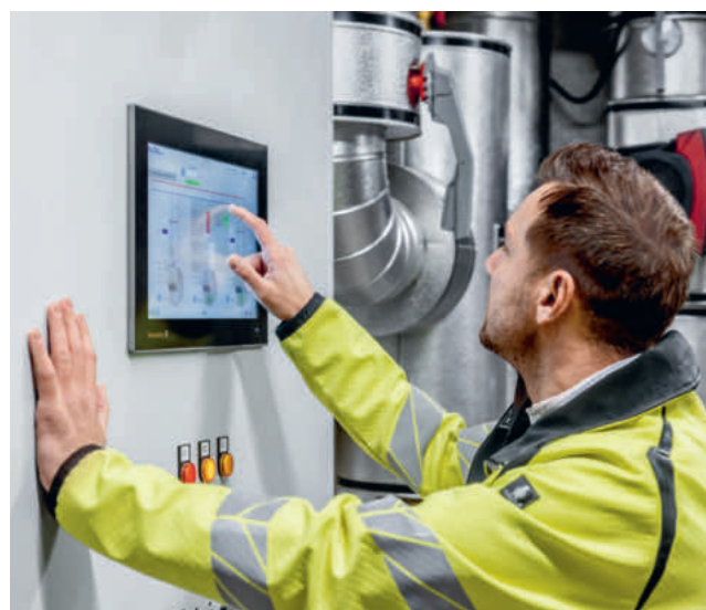
Tony Caputo contrôle les paramètres de l'installation.
