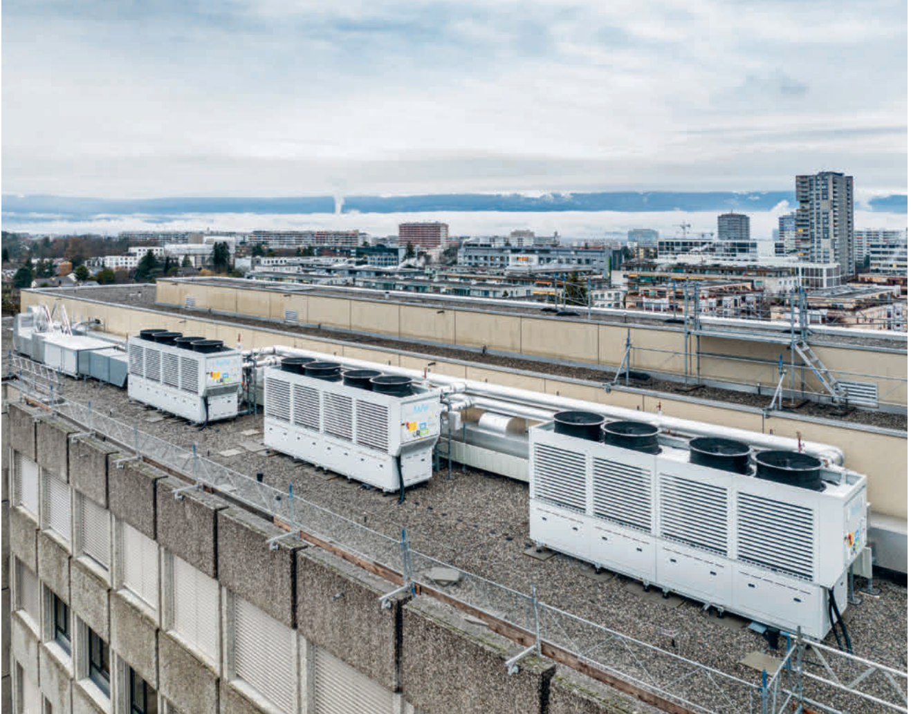
Starke Leistung vom Dach: die Wärmepumpe vom Typ PICO RO 8000 (ganz links) und die drei AxAir Enerblue Grosswärmepumpen. (Bilder: rl)
