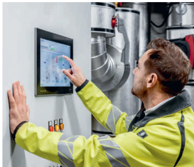
Tony Caputo kontrolliert die Parameter der Anlage.
