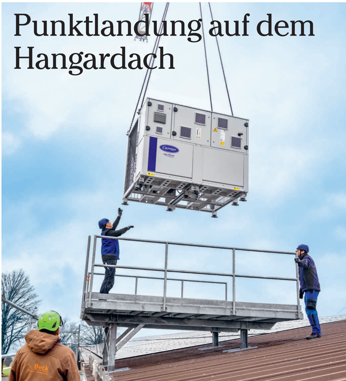
Grosswärmepumpe im Landeanflug: Präzision und Geschick bei der Ankunft auf dem Hangardach. (Bilder: rl)
