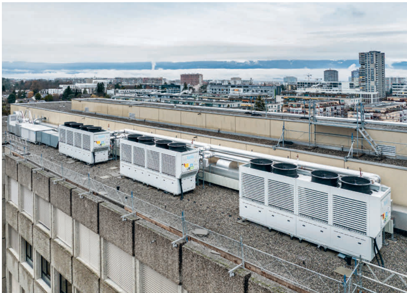
Tanta potenza dal tetto: la pompa di calore di tipo PICO RO 8000 (all'estrema sinistra) e le tre grandi pompe di calore AxAir Enerblue. (Foto: rl)
