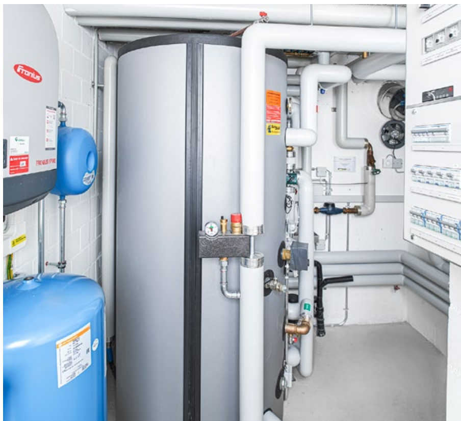
Sopra: sistema complesso, realizzazione semplice. A sinistra, l'invertitore e il vaso d'espansione; al centro, l'accumulatore combinato; a destra, il pannello con il gestore d'energia solare Smartfox Pro.
