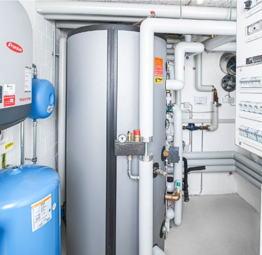
Oben: Komplexes System, einfache Umsetzung: Wechselrichter und Ausgleichsgefäß (links), Kombispeicher (Mitte) und rechts das Tableau mit dem Solarmanager Smartfox Pro.
