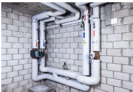
Visione di insieme dell'impianto (in alto), lo schermo touch dell'unità di gestione (al centro) e il nuovo gruppo di riscaldamento nell'edificio residenziale.
