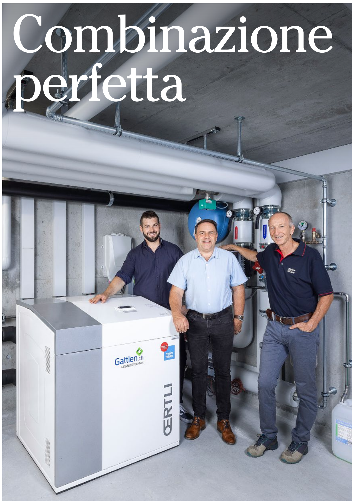
Ammodernamenti del riscaldamento realizzati con successo (da sinistra): Patrik Escher, Werner Zurkirchen e Leander Tscherrig con la pompa di calore Oertli SI-GEO 25-100. (Foto: rl)
