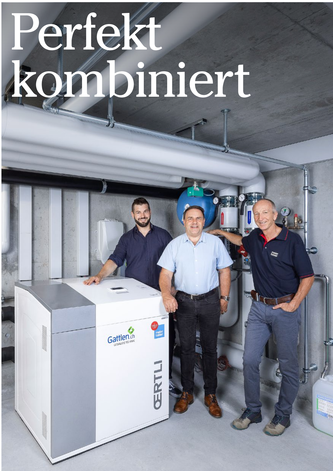
Erfolgreich umgesetzte Heizungserneuerung (v. l.): Patrik Escher, Werner Zurkirchen und Leander Tscherrig mit der Wärmepumpe Oertli SI-GEO 25-100. (Bilder: rl)
