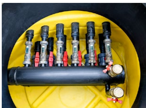
Les différents éléments de la nouvelle installation dans la Pfaffenwiesenstrasse 50/52/54 (à gauche et en haut) ainsi que l'un des distributeurs des sondes géothermiques, situé sous la pelouse entre les bâtiments.
