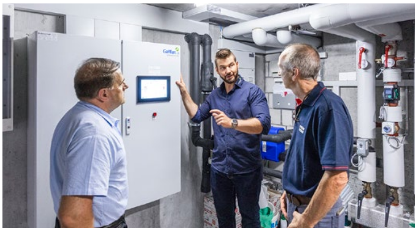
« Le cerveau de tout le système » – Patrik Escher (au milieu) avec Werner Zurkirchen (à gauche) et Leander Tscherrig (à droite) près de l'installation de commande.
