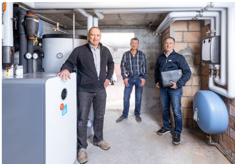
Il y a beaucoup plus de place dans la chaufferie qu'avant avec l'ancien chauffage à mazout (d. g. à d.): Beat Rubin, Stefan Wyss (Wyss Heizungen AG) et Fabio Rugoletti (conseiller de vente chez Meier Tobler).
