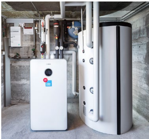
Pompa di calore terra-acqua Bosch CS7800i 12 LW (a sinistra) con accumulatore per riscaldamento Oertli SHW 807.
