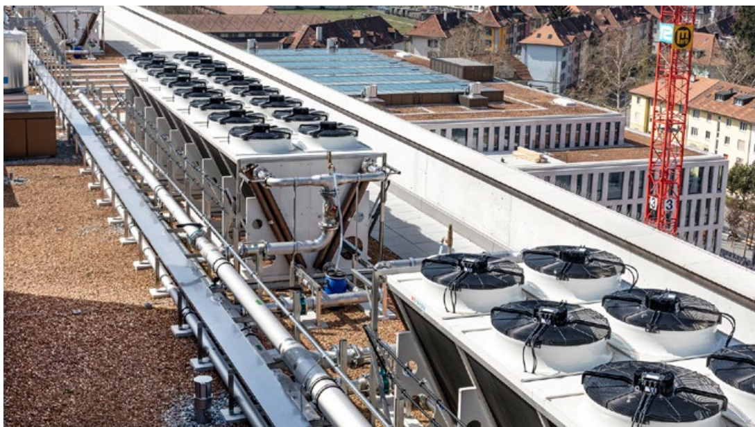
Aerorefrigeranti Refrion installati sul tetto dell'edificio principale (a sinistra).
