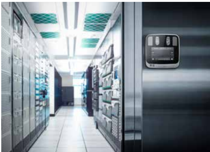
Online-Zutrittskontrolle z.B. für IT-Räumlichkeiten
