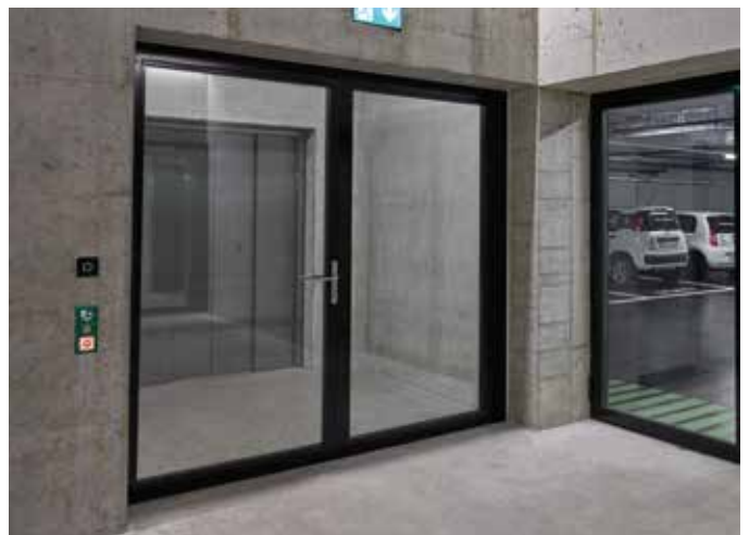
SafeRoute-System und Leser für Garagenzugänge
