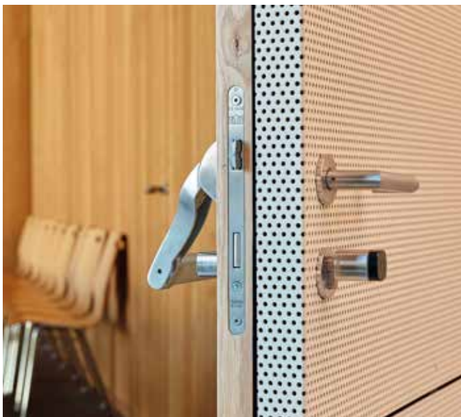
Zutrittskontrolle mittels Digitalzylinder, z.B. für Konferenzräume; Türinnenseite mit Panikgriffstange
