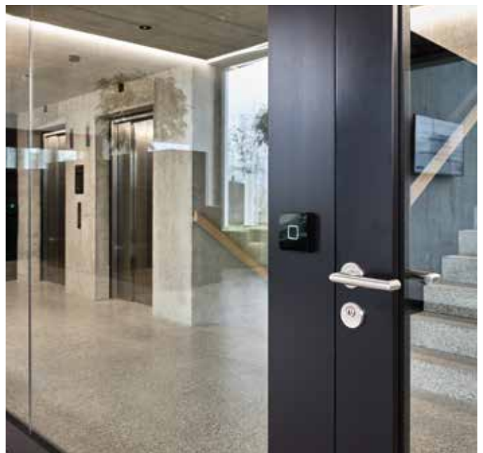
Sicherung der Zugänge im Treppenhaus. Zutrittsautorisierung mittels Kompaktleser 90 01
