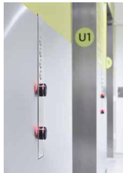
Aufzugsteuerung: die Nutzungsberechtigungen der Aufzuganlagen werden individuell aktiviert
