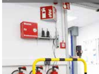
Brandschutzeinrichtungen gemäß ASR A2.2
