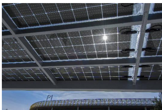
► Geïntegreerde zonnepanelen in de dakluifels bij de taxistandplaats
