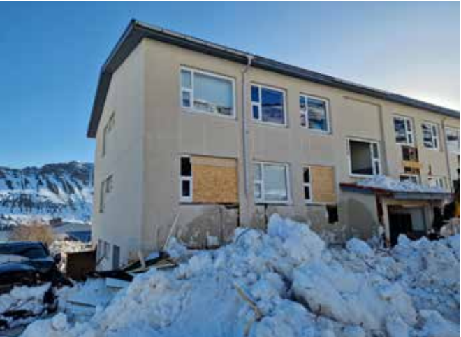
Mynd 4 Skemmdir á fjöbýlishúsi vegna snjóflóðs í Neskaupsstað
