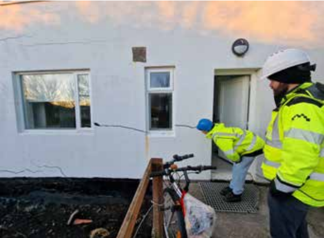
Mynd 3 Sprungur í útvegg vegna mismunasigs
