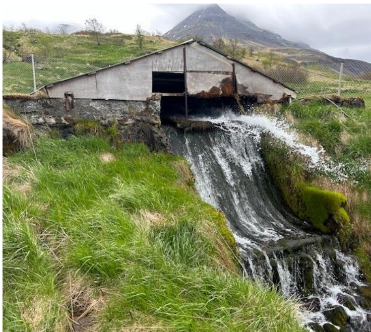
Mynd 3.4: Sýnir neðsta damm áður en vatn fer inn í stöðina.
