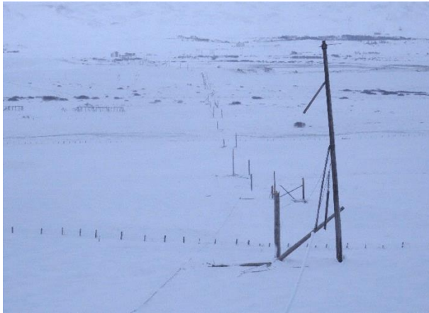
Mynd 2: 66 kV Dalvíkurlína 1, 31 tréstaumastur brotnuðu í ísingarveðrinu 10.–11. des. 2019.
