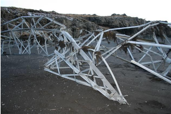
Mynd 18: Mastur í 220 kV Brennimelslínu 1 féll í Þyrilsnesi í Hvalfirði árið 2007, m.a. vegna vindáraunar.
