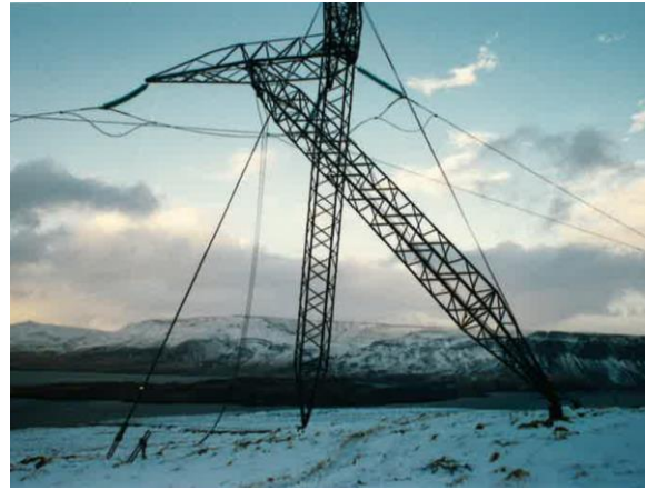
Mynd 3: 220 kV Brennimelslína 1, brot á Þrándarstaðafjalli í Hvalfirði 3. febrúar 1991.
