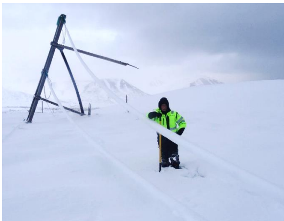
Mynd 14: Ísingarveðrið á norðurlandi 10.-11. desember 2019. Línubrot í 132 kV Dalvíkurlínu.
