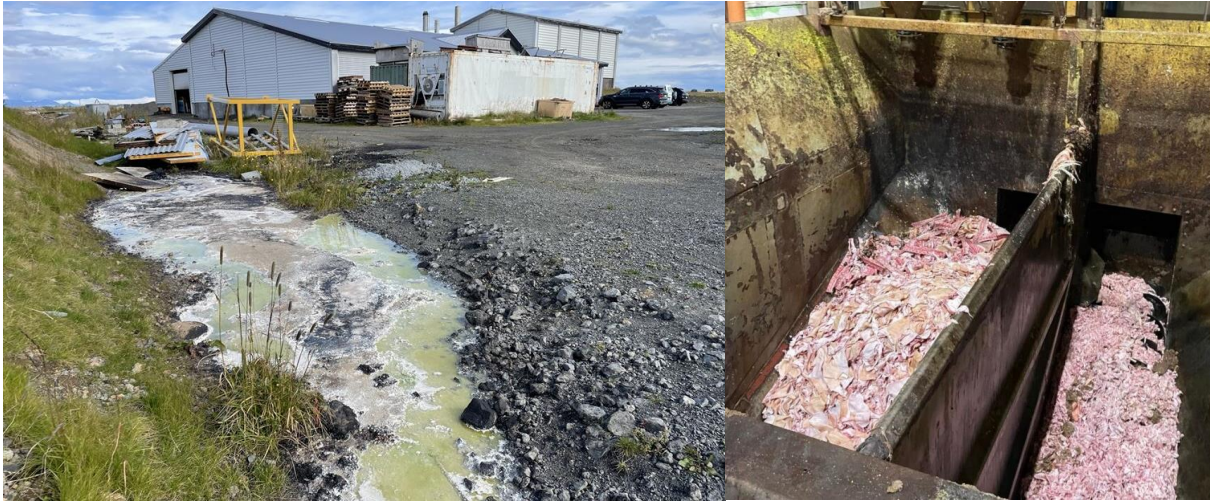
Mynd 4 Í Orkugerðinni á Suðurlandi er unnið með lífrænan úrgang í opnu ferli (10,5 þúsund tonn árið 2024 svk. grænu bókhaldi) og hönnun stöðvarinnar, rekstur og meðhöndlun úrgangs verulega frábrugðin því sem verður í fyrirhugaðri endurnýtingarstöð. Lokaafurðin er kjötmöl sem er sett í opna stórsekki. Myndir: Svanhvít Hermannsdóttir (t.v.), Terraforming Life (t.h.).
