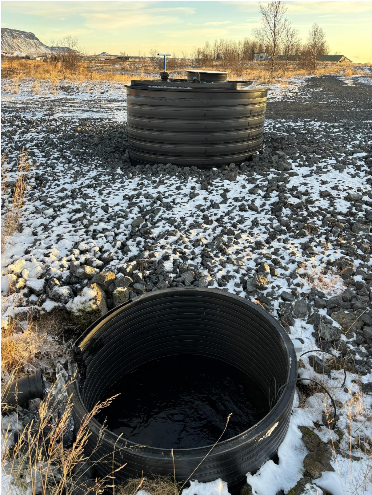
Mynd 13 Brunnar við Öxnalækjarból. Neðs til hægri sjást vatnshæðamæar liggja ofan í brunninn.
