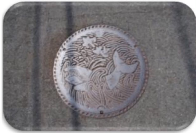
下水道マンホールの蓋
