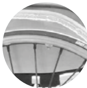
CE15 Rohrbogen, mit Aluminiumblech verkleidet
