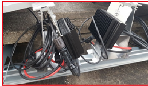
Voorbeeld: niet correct- de bekabeling is zo strak rond de frames gewikkeld dat dit insnijding in de bekabeling gaat veroorzaken, met vlamboog/brand tot gevolg
