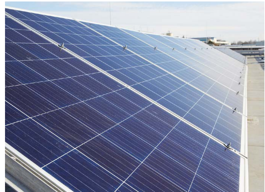
Eigene Stromerzeugung durch Photovoltaik: Unsere PV-Anlagen erzeugen so viel Energie, dass damit der jährliche Stromverbrauch von 160 Einfamilienhäusern gedeckt werden kann.
