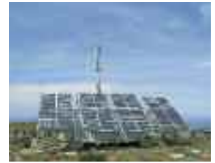
Φωτοβολταϊκό σύστημα σε Σταθμό Βάσης
