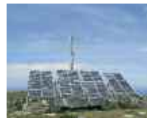
Φωτοβολταϊκό σύστημα σε Σταθμό Βάσης
