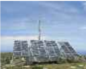
1. Φωτοβολταϊκό σύστημα σε Σταθμό Βάσης 2,3. Πιλοτικός «Πράσινος» Σταθμός Βάσης
