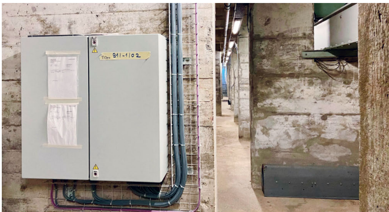
Armoire de commande pour l'extraction des cellules 1-50
