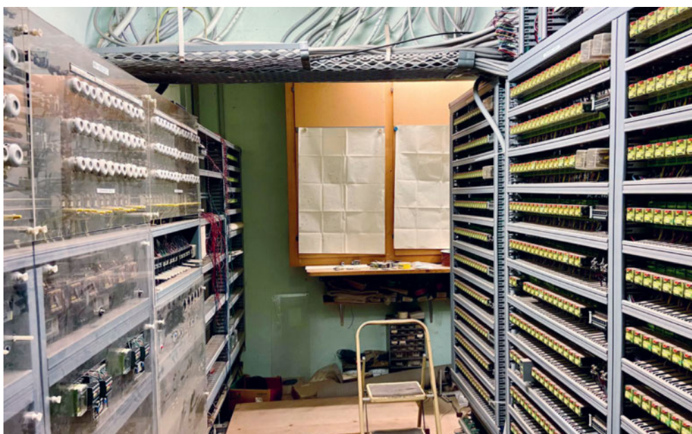
Ancienne centrale électrique, alimentée par 450A
