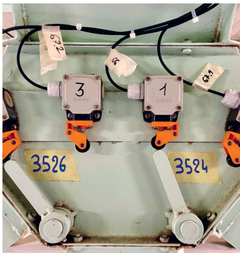
Clapets de direction des cellules du silo 2
