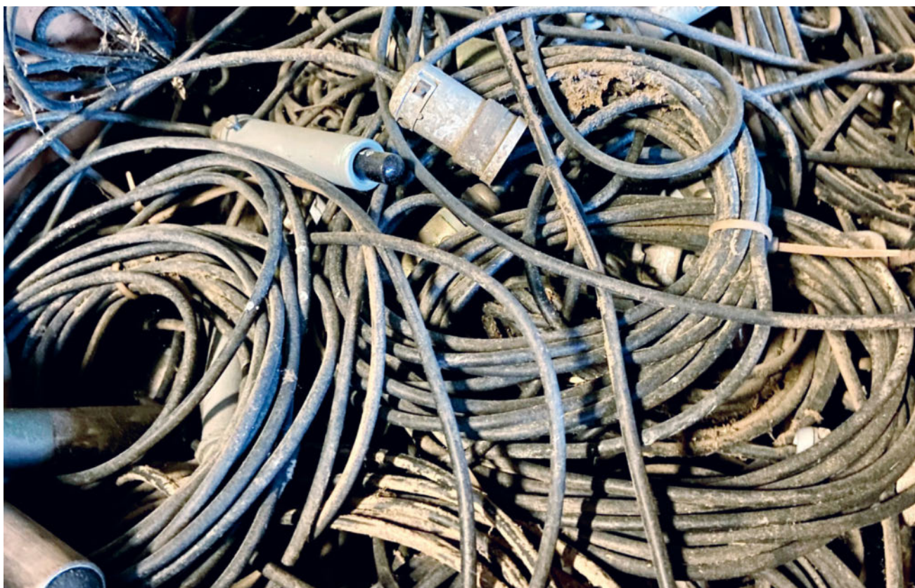
Câblage des anciennes sondes des cellules
