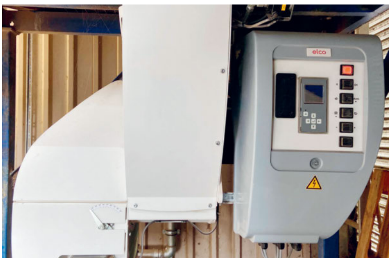
Nouveau brûleur à gaz du grand séchoir
