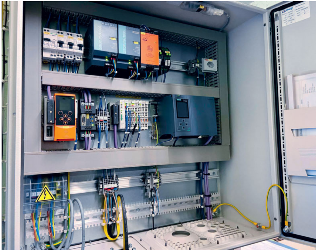
Armoire de commande principale du centre collecteur et son automate
