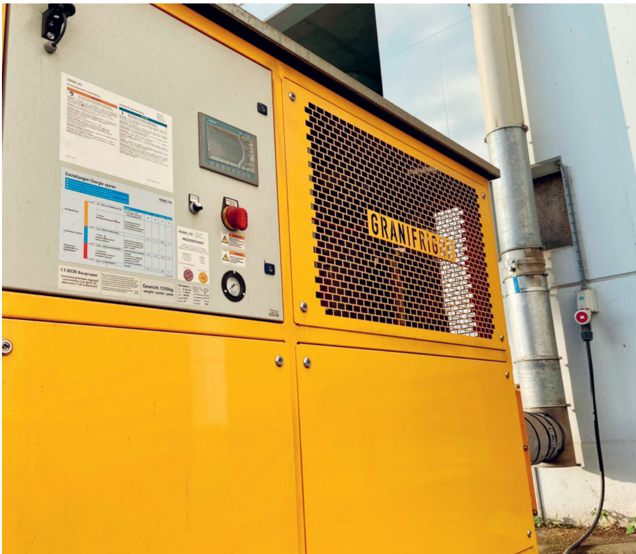
Nouveau Granifrigor : système de refroidissement des cellules
