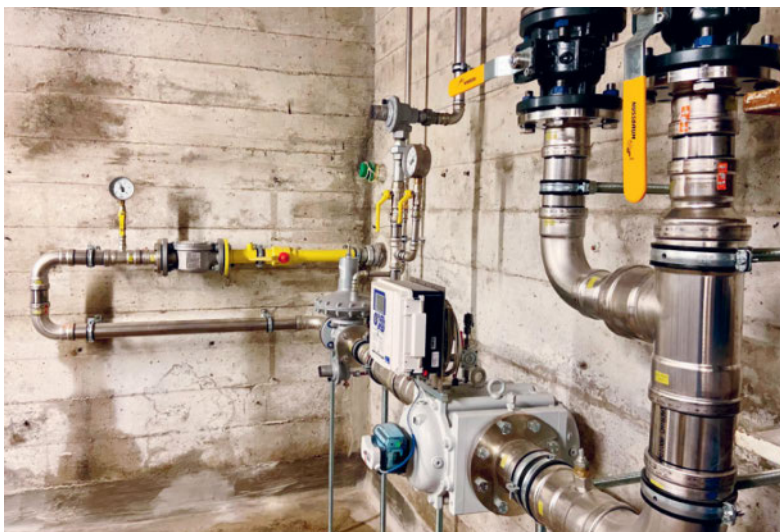
Rampe d'introduction du gaz pour le séchoir
