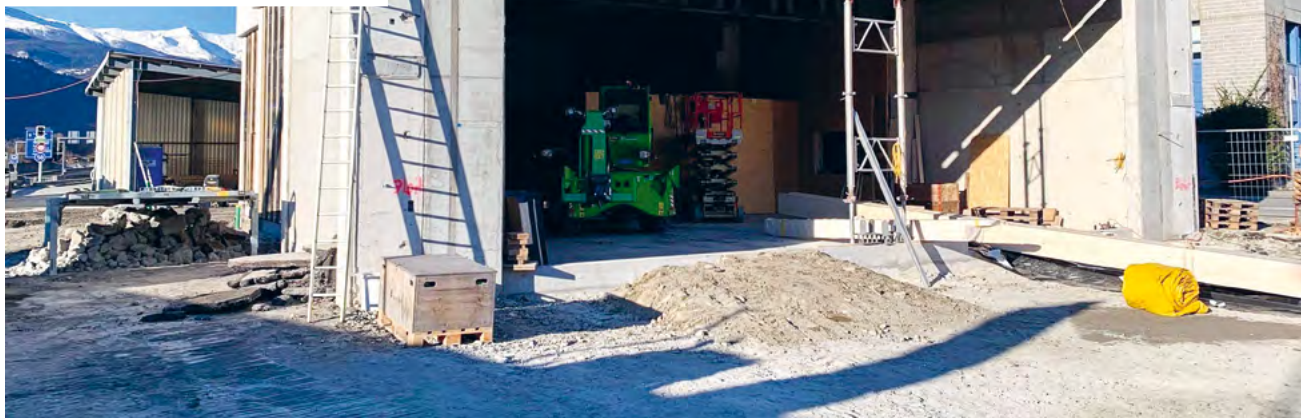
Umbauarbeiten in vollem Gange: Hier in Brig entsteht bis Mai 2023 die neue AGROLA Tankstelle mit TopShop.
